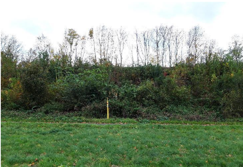
Abb. 12: Bahndamm mit Gebüschaufwuchs im Querungsbereich
